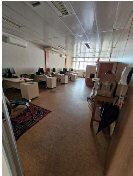
Foto 3: forro modulado em PVC com estrutura de fixação metálica a ser removida.
