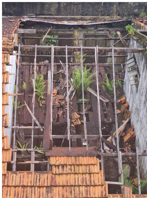
Foto 8: parte do telhado desabado.
