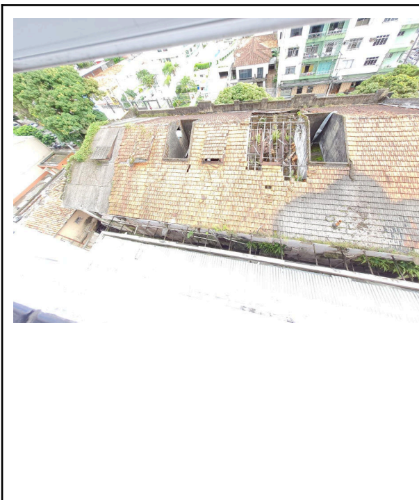
Foto 5: cobertura, parcialmente desmoronada
